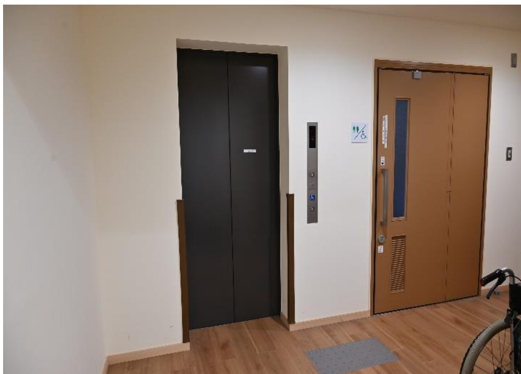
法務棟 1 階エレベーター
