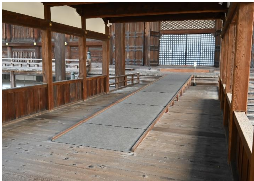
堂内の段差部分に設置されたスロープ
