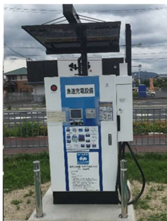
電気自動車の充電設備
