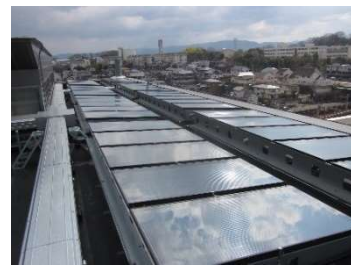
太陽熱温水器 集熱パネル （北部会館）
